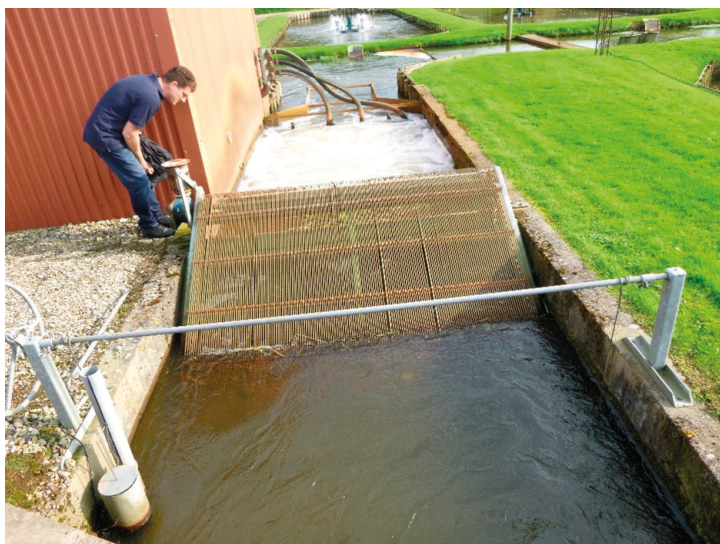
Obr. 4: Česlová stěna a následné provzdušňování
