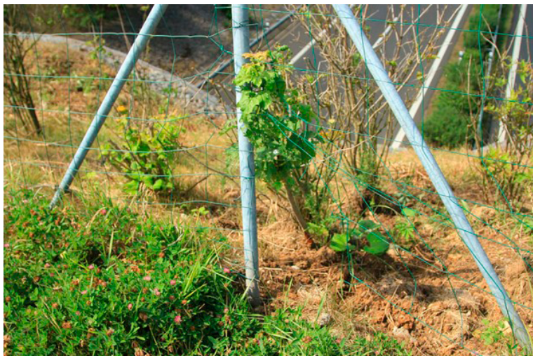
2: Poškozené oplocení podél komunikace je třeba uvést do řádného stavu, jinak neplní svou funkci – ekodukt Jenišov na D6
